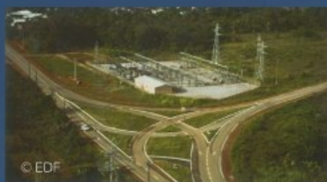
Poste source de Balata
