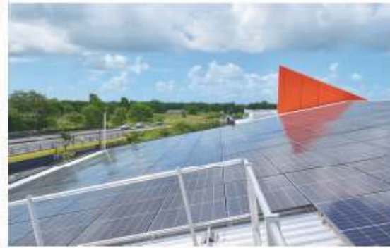
500 m² de panneaux photovoltaïques installés pour couvrir une partie de la consommation de la concession
